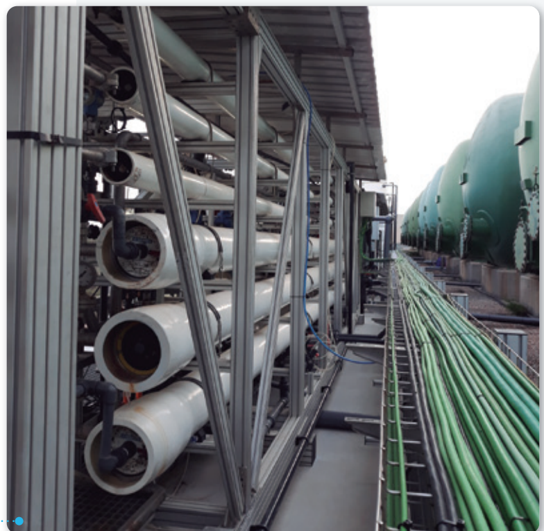
Figura 3. Sistema de OI y pretratamiento de salmuera mediante nanofiltración. Figure 3. RO system and NF brine pretreatment
